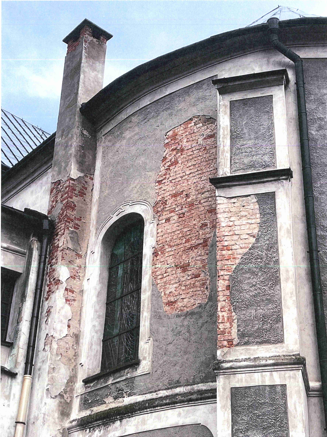
Fot. nr 10 Kościół p.w. św. Franciszka z Asyżu w Głogówku. Zespół klasztorny o.o. Franciszkanów. Widok od strony południowo-zachodniej. Widoczne naturalne odkrywki, ubytki tynków cementowo-wapiennych. Pod spodem widoczne pozostałości wypraw wapienno-piaskowych.
